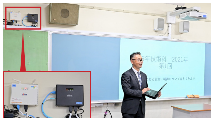
▲左上壁面に設置されたSKY-AP-302AN(白)を利用し、プロジェクターに無線で投影
